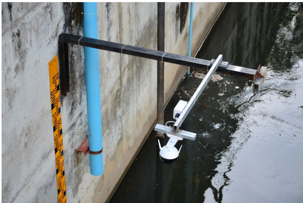
รูปที่ 38 ติดตั้งกล้องวงจรปิดด้านเหนือน้ำฝายคลองสวนหมาก
